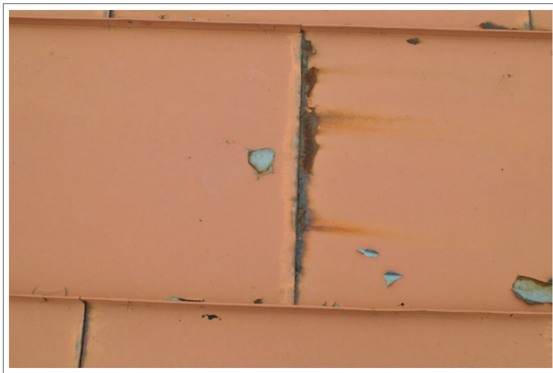
FOT 1-023. 04.06.2012 – Żernica ul. Leopolda Miki 37 - obiekt szkolno-przedszkolny - widoczne zbliżenie charakterystycznego miejsca korozji pokrycia dachowego.
