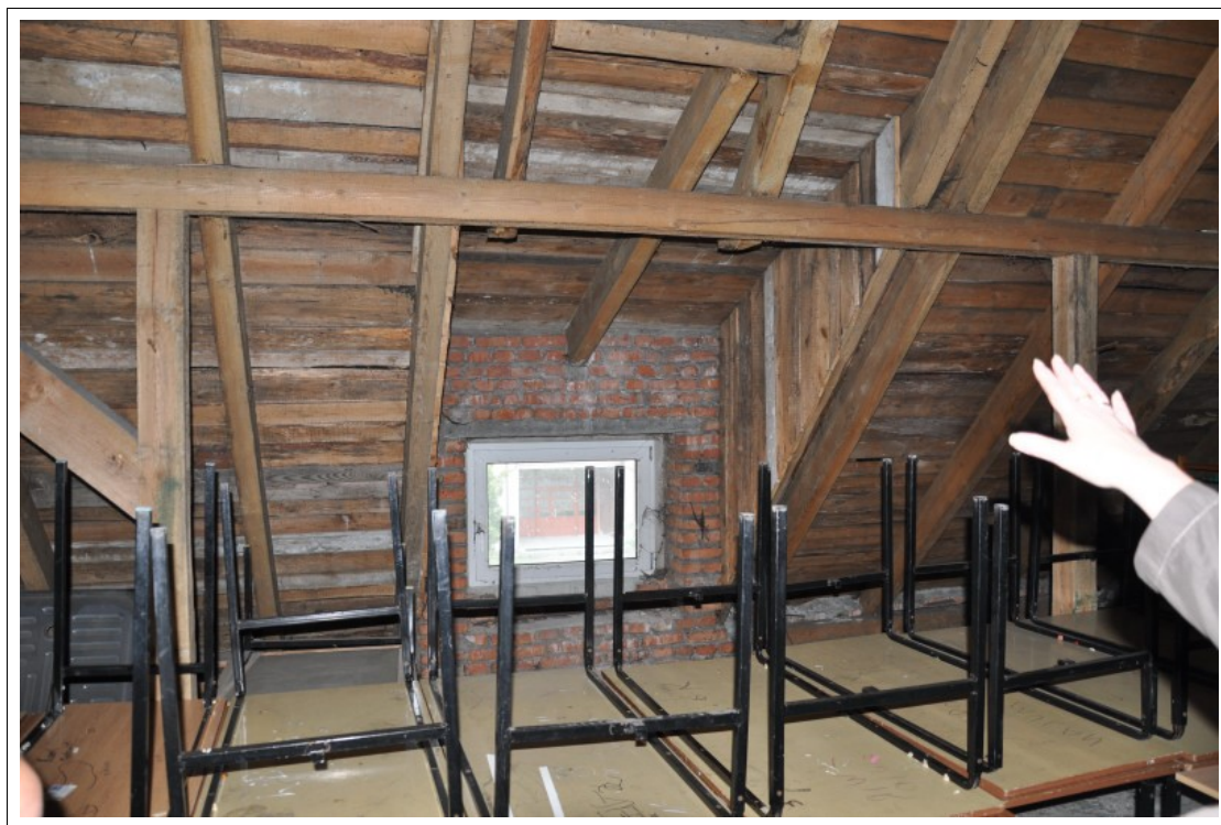
FOT 1-029. 04.06.2012 – Żernica ul. Leopolda Miki 37 - obiekt szkolno-przedszkolny - poddasze segment F - osadzenie lukarny, niestaranne wykonanie.
