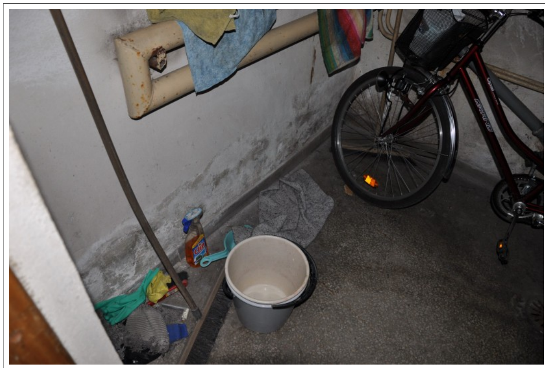
FOT 1-036. 04.06.2012 – Żernica ul. Leopolda Miki 37 - obiekt szkolno-przedszkolny - widoczne zawilgocenie ścian przy posadzce piwnicy.
