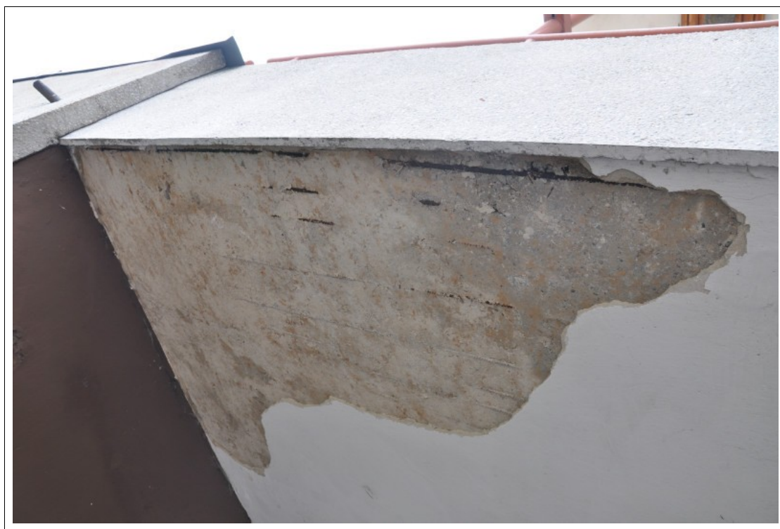
FOT 1-018. 04.06.2012 – Żernica ul. Leopolda Miki 37 - obiekt szkolno-przedszkolny - ujęcie j.w. - widoczny ubytek tynku na stropie, odsłonięte i skorodowane zbrojenie nośne.
