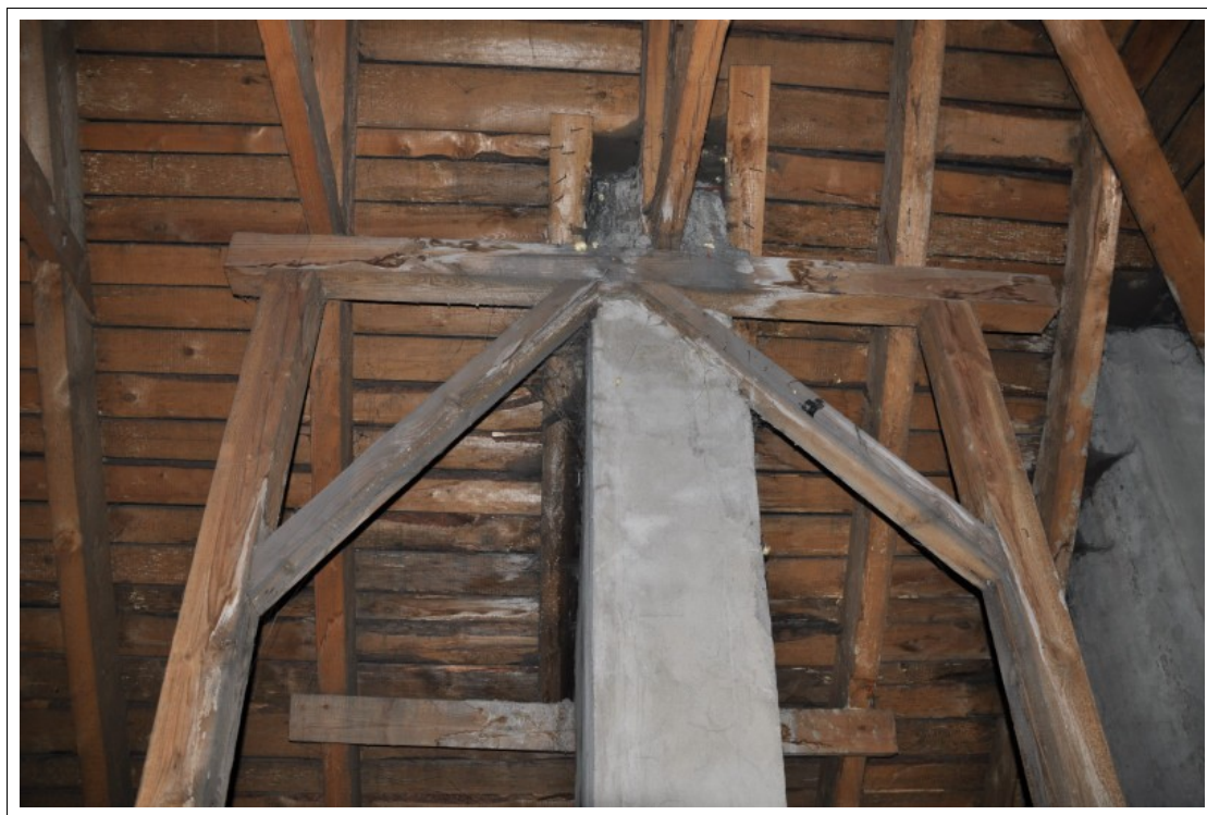
FOT 1-031. 04.06.2012 – Żernica ul. Leopolda Miki 37 - obiekt szkolno-przedszkolny - poddasze segment F - fragment więźby z przejściem kominowym, niestaranne wykonanie.
