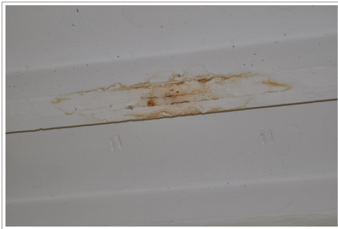
FOT 1-034. 04.06.2012 – Żernica ul. Leopolda Miki 37 - obiekt szkolno-przedszkolny - sala gimnastyczna - zarysowane złącze pomiędzy płytami dachowymi, widoczne ślady penetracji wód opadowych i korozji.
