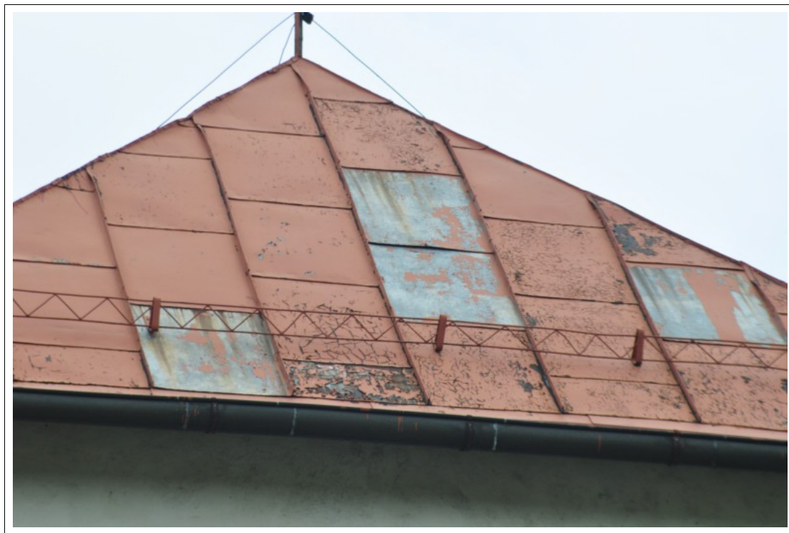
FOT 1-022. 04.06.2012 – Żernica ul. Leopolda Miki 37 - obiekt szkolno-przedszkolny - widoczne ubytki i złuszczenia powłok lakierniczych, oraz korozja pokrycia dachu.
