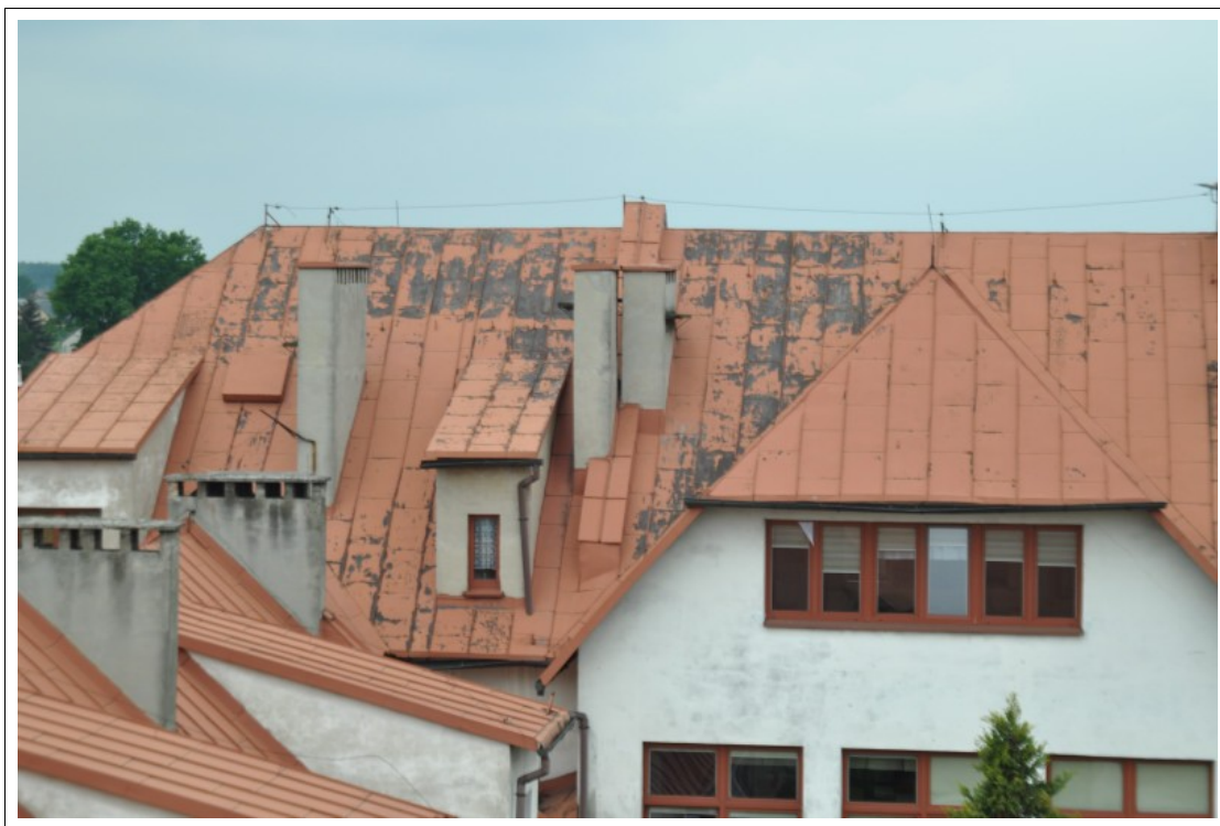
FOT 1-019. 04.06.2012 – Żernica ul. Leopolda Miki 37 - obiekt szkolno-przedszkolny - widok wschodniej połaci dachu segmentu A - widoczne złuszczające się powłoki lakiernicze pokrycia dachu.
