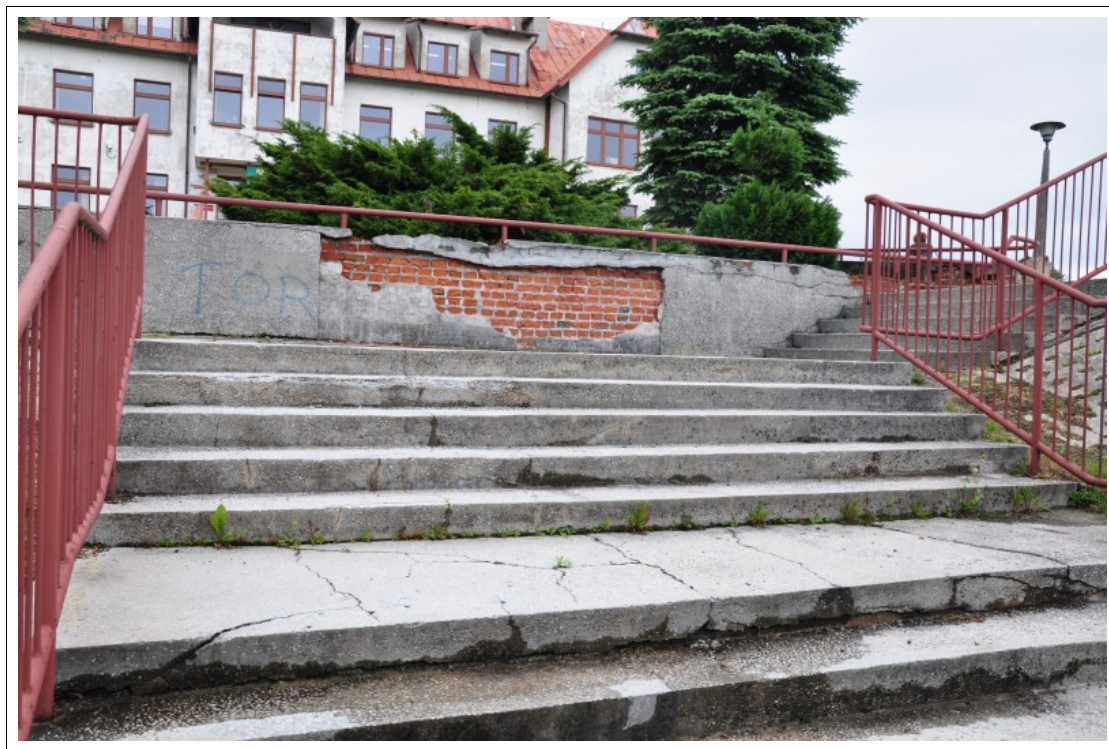
FOT 1-010. 04.06.2012 – Żernica ul. Leopolda Miki 37 - obiekt szkolno-przedszkolny - widoczny rozmrożony tynk i zdegradowana cegła muru oporowego, spękane i rozmrożone stopnie, zdegradowane biologicznie.
