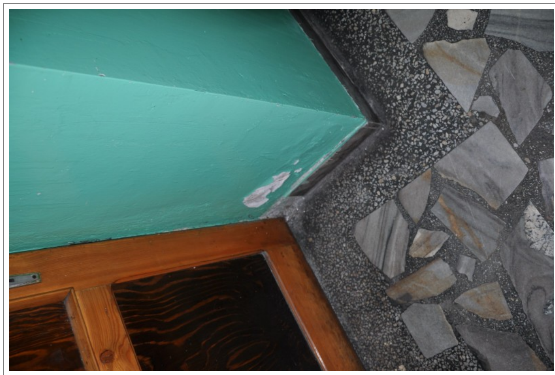
FOT 1-035. 04.06.2012 – Żernica ul. Leopolda Miki 37 - obiekt szkolno-przedszkolny - widoczne zawilgocenie ścian przy posadzce parteru.
