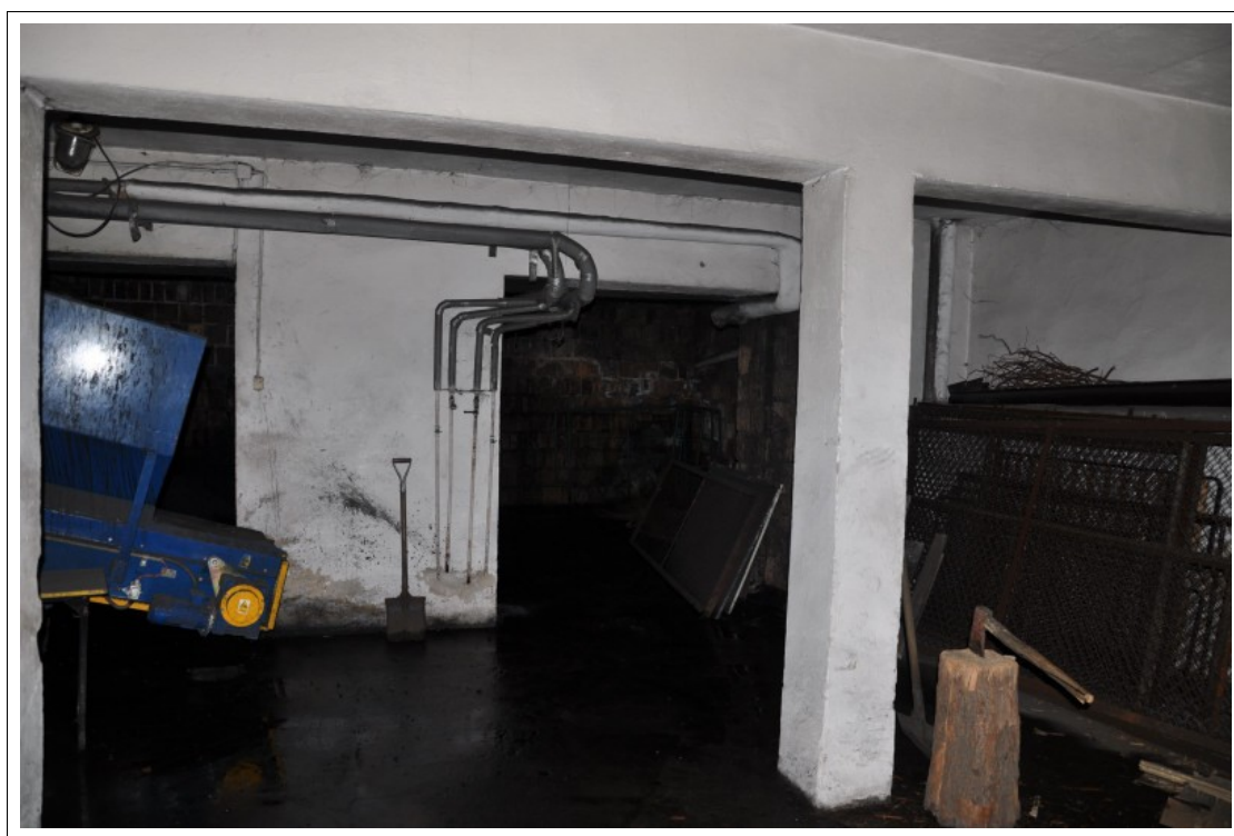
FOT 1-037. 04.06.2012 – Żernica ul. Leopolda Miki 37 - obiekt szkolno-przedszkolny - piwnica kotłownia/skałd opału.
