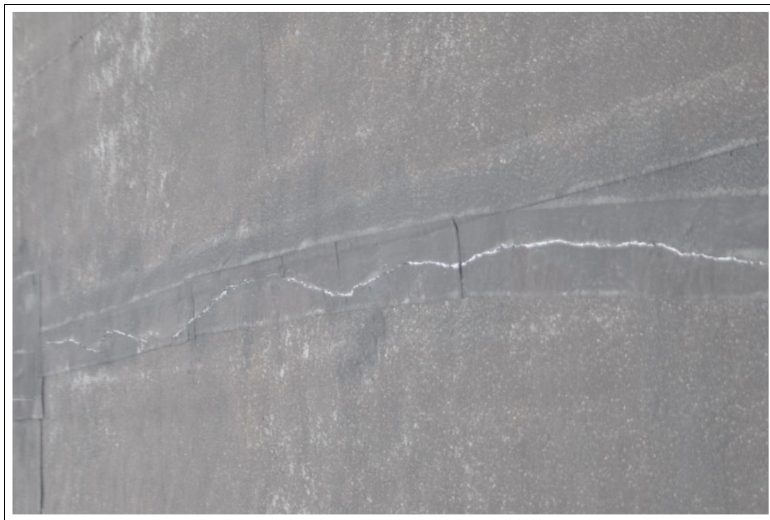
FOT 1-026. 04.06.2012 – Żernica ul. Leopolda Miki 37 - obiekt szkolno-przedszkolny - dach sali gimnastycznej - widoczne pęknięcie membrany pomimo wcześniejszych reparacji.
