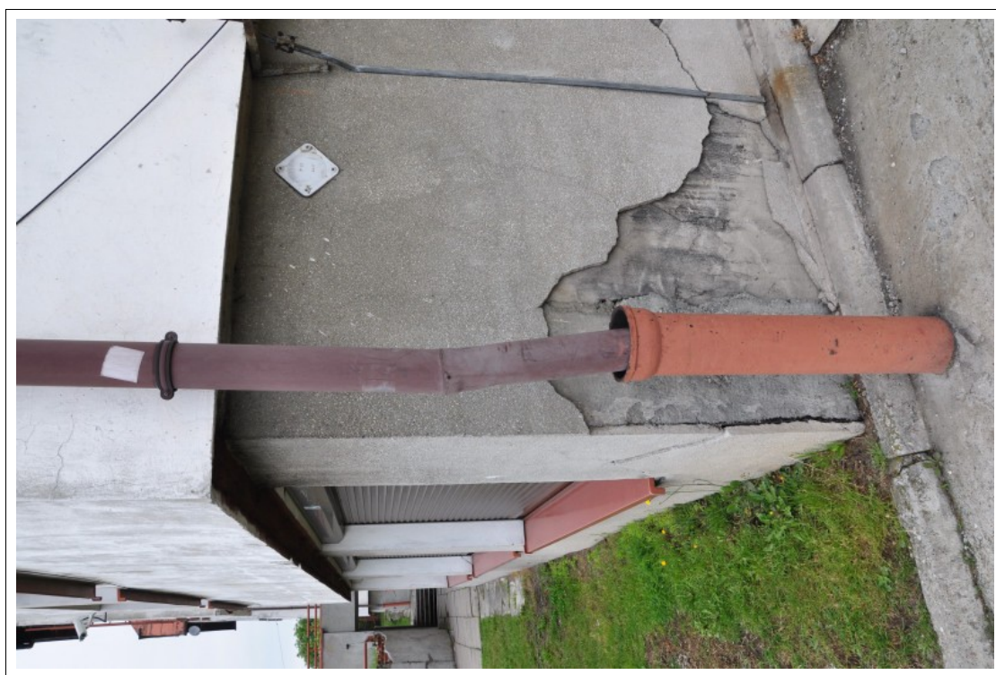
FOT 1-013. 04.06.2012 – Żernica ul. Leopolda Miki 37 - obiekt szkolno-przedszkolny - niefachowo zmontowana rura spustowa, spękana i odspojona okładzina elewacyjna lastrico na skutek podciekania wody, widoczny ubytek.
