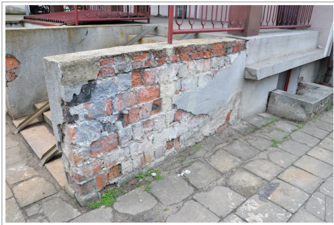
FOT 1-008. 04.06.2012 – Żernica ul. Leopolda Miki 37 - obiekt szkolno-przedszkolny - wejście do segmentu E od strony wschodniej - zdegradowany murek oporowy przy schodach.
