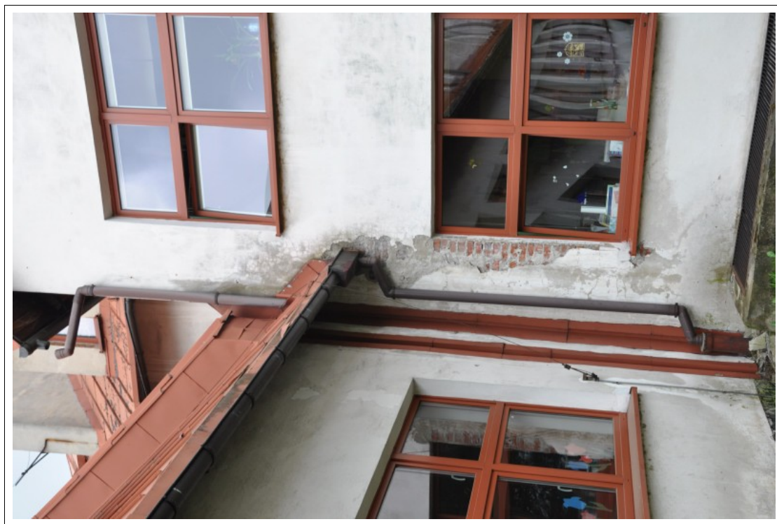
FOT 1-009. 04.06.2012 – Żernica ul. Leopolda Miki 37 - obiekt szkolno-przedszkolny - fragment dziedzińca - widoczna urwana rura spustowa, korozja pokrycia dachowego, niefachowo wykonany odbiór wody z wyższej kondygnacji, zdegradowany tynk.
