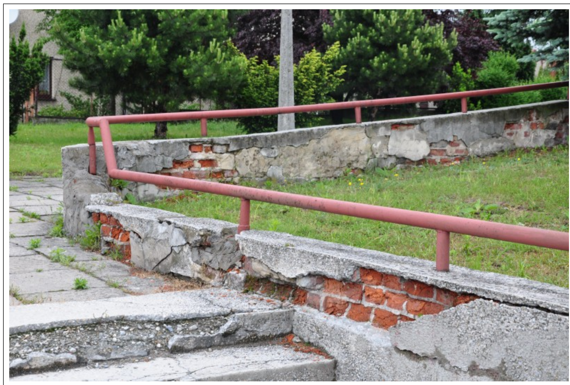
FOT 1-011. 04.06.2012 – Żernica ul. Leopolda Miki 37 - obiekt szkolno-przedszkolny - j.w. rozmrożony mur oporowy i stopnie.
