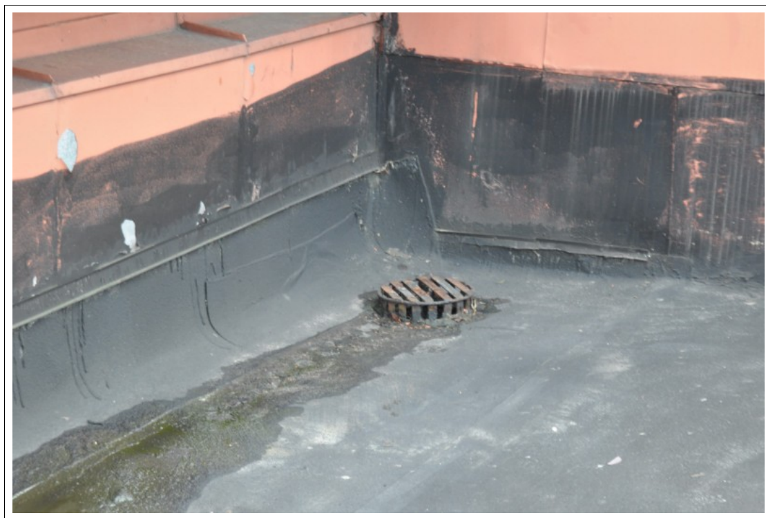
FOT 1-025. 04.06.2012 – Żernica ul. Leopolda Miki 37 - obiekt szkolno-przedszkolny - dach sali gimnastycznej - widoczne niestaranne i niefachowe wykończenia membrany uszczelniającej do ścian.
