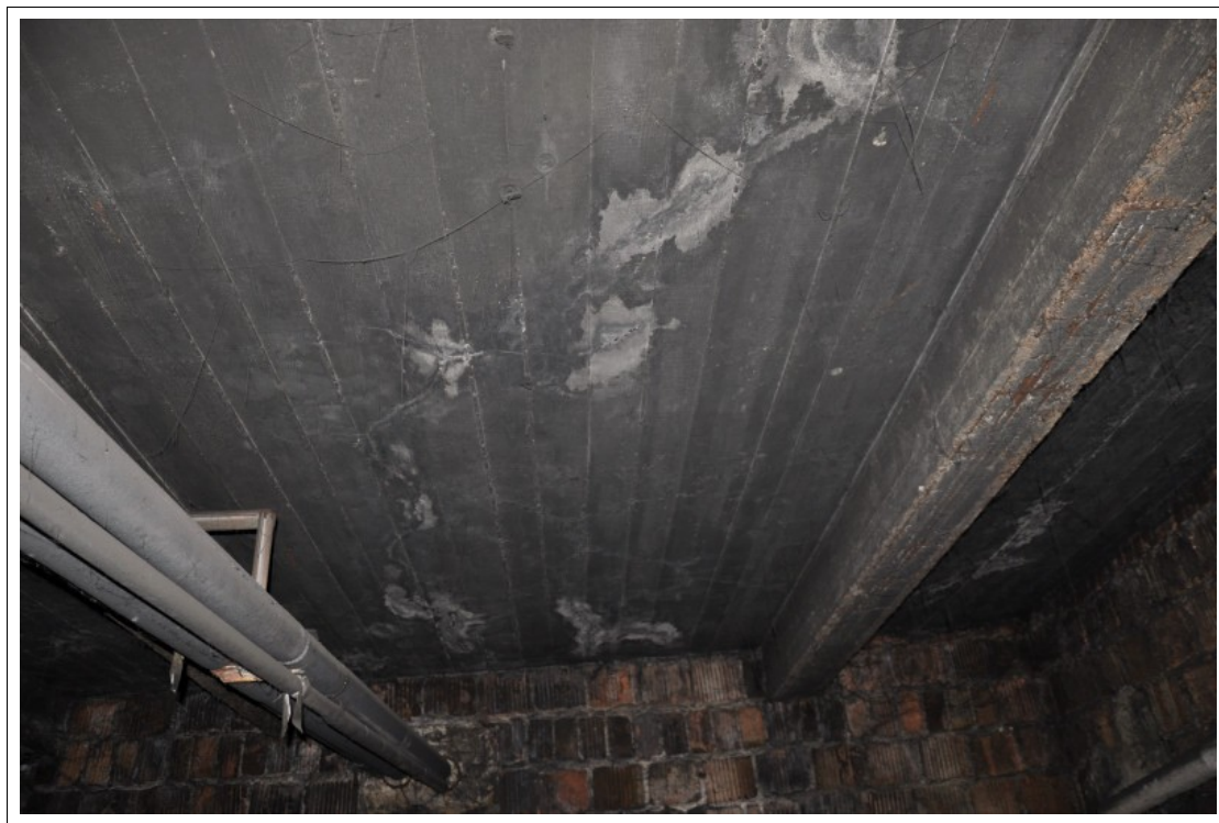
FOT 1-040. 04.06.2012 – Żernica ul. Leopolda Miki 37 - obiekt szkolno-przedszkolny - j.w., widoczna skorodowana belka z odsłoniętym zbrojeniem w głębi zsypania oraz zarysowana, przeciekająca płyta stropu.
