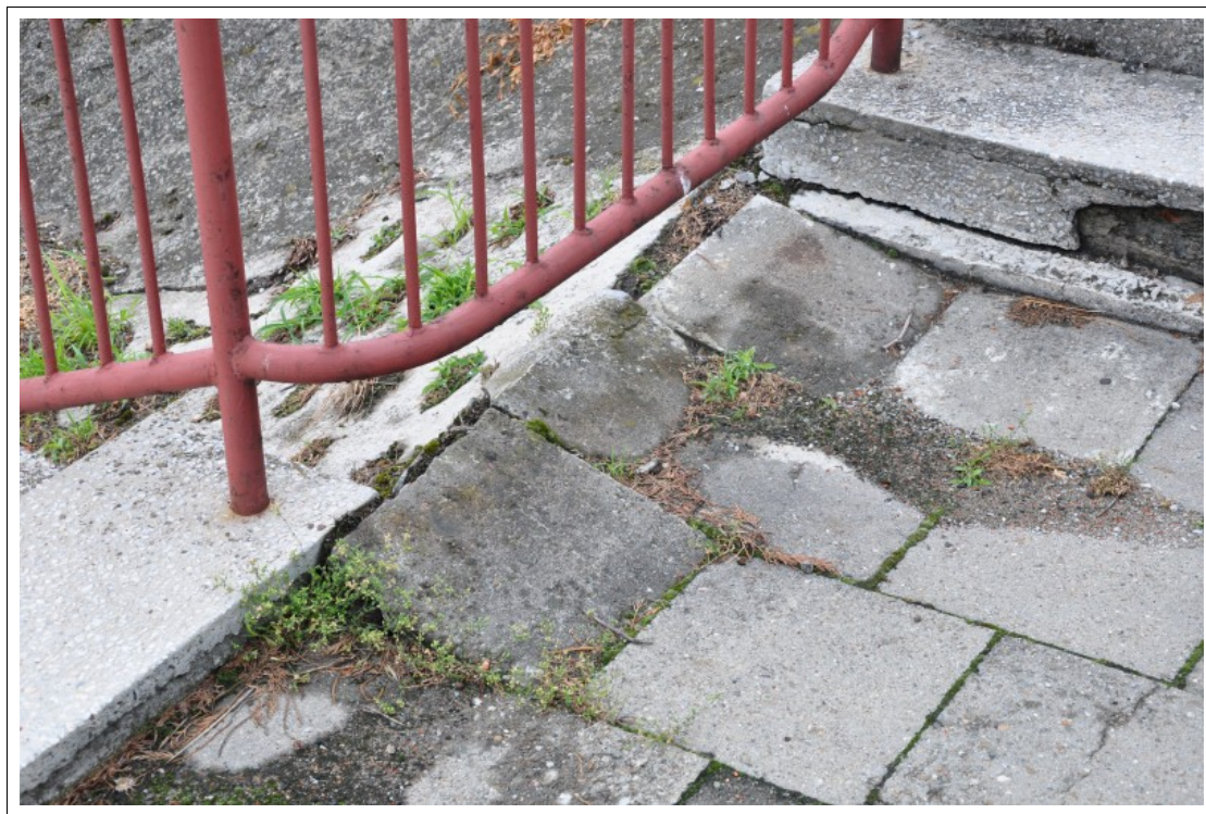
FOT 1-012. 04.06.2012 – Żernica ul. Leopolda Miki 37 - obiekt szkolno-przedszkolny - zapadnięty i zdegradowany biologicznie chodnik, uszkodzone, rozmrożone stopnie.
