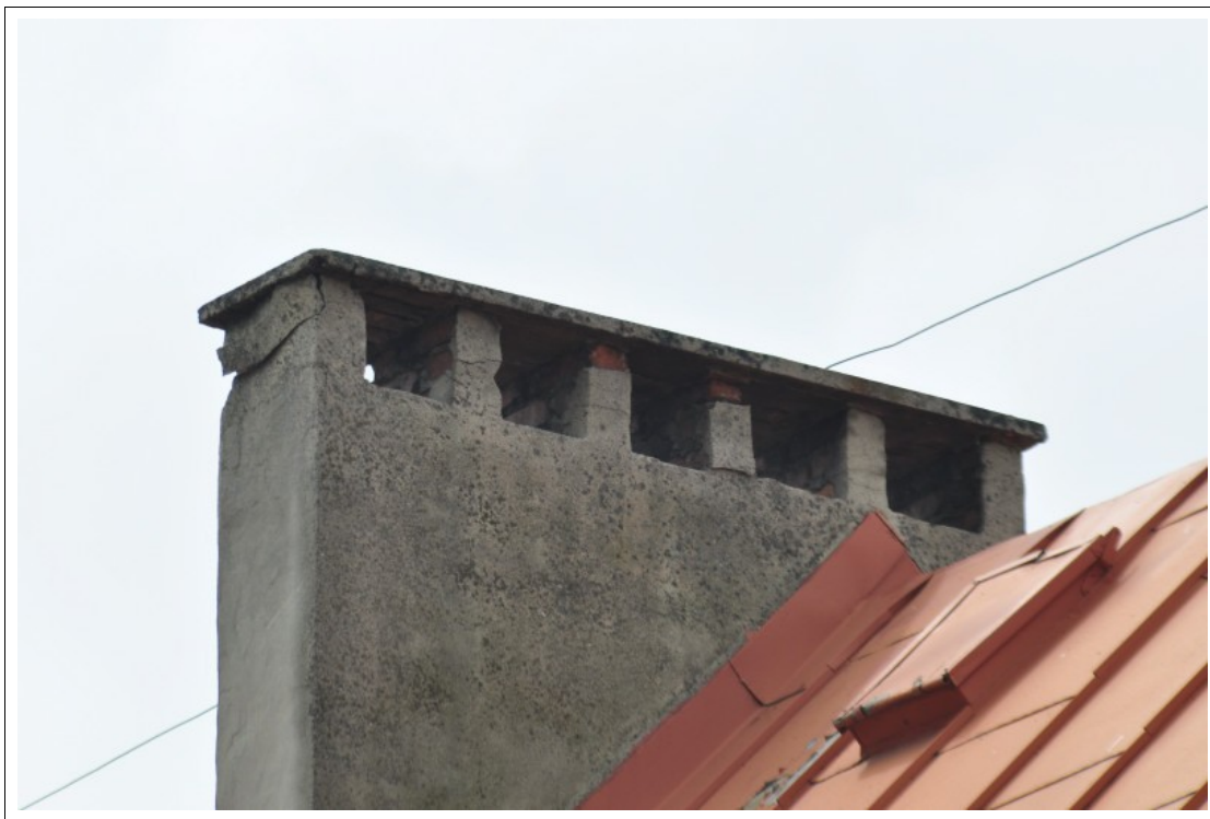
FOT 1-020. 04.06.2012 – Żernica ul. Leopolda Miki 37 - obiekt szkolno-przedszkolny - widok zdegradowanego przez wody opadowe komina.
