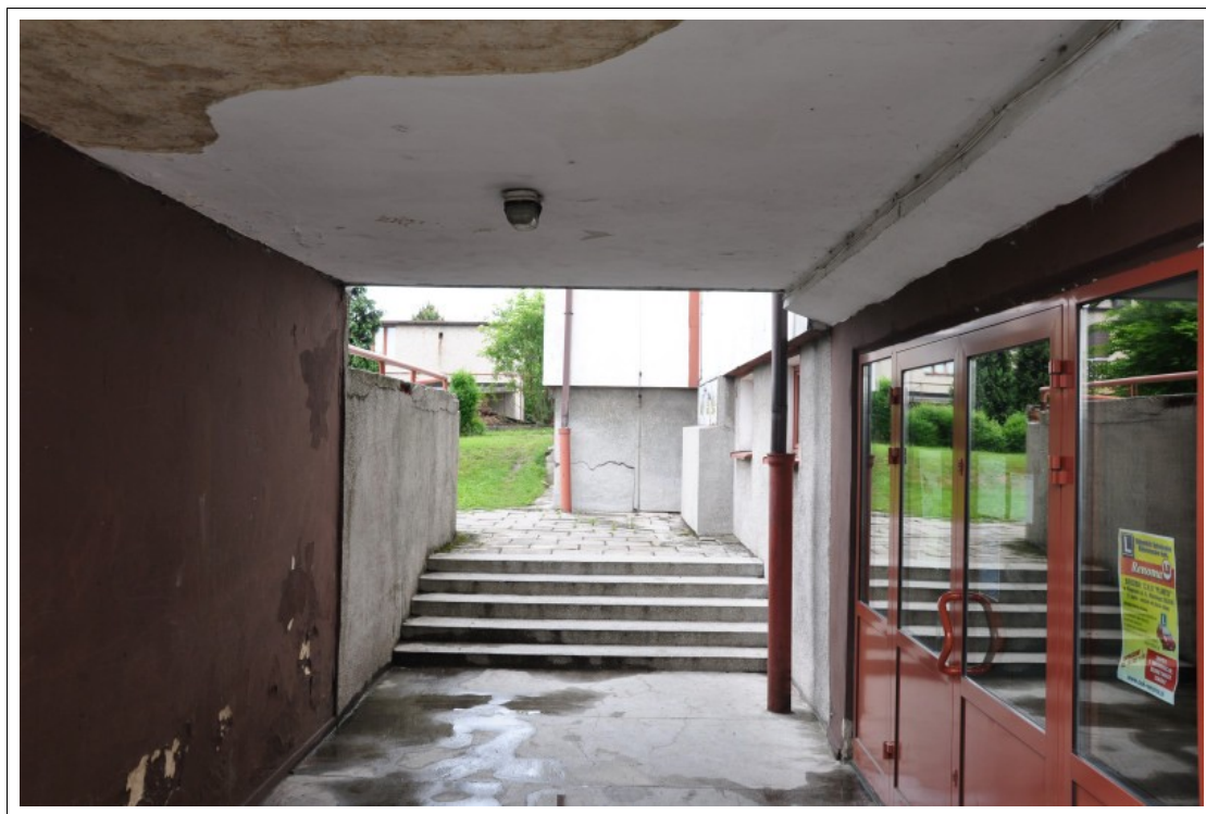
FOT 1-017. 04.06.2012 – Żernica ul. Leopolda Miki 37 - obiekt szkolno-przedszkolny - wejście do budynku pod schodami głównego portalu - widoczne znaczne zawilgocenia ściany i odspojony tynk stropu.
