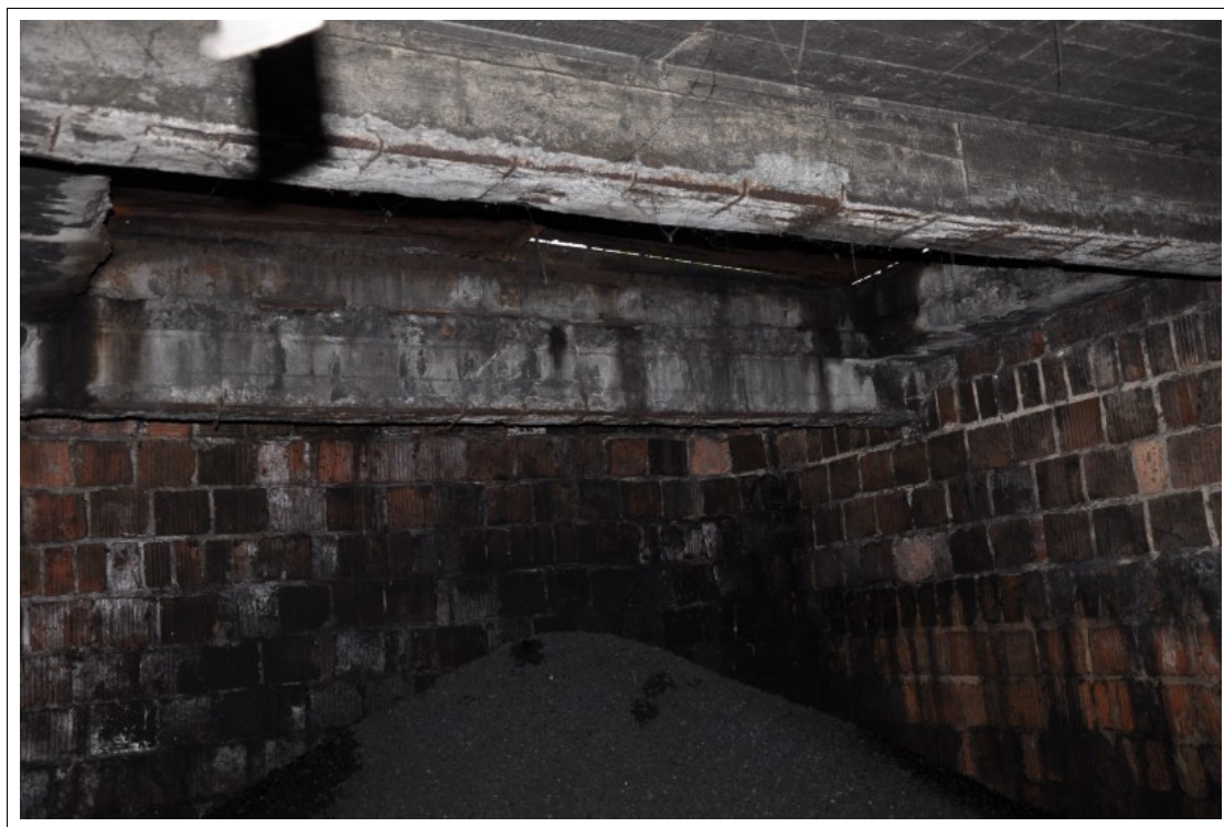
FOT 1-039. 04.06.2012 – Żernica ul. Leopolda Miki 37 - obiekt szkolno-przedszkolny - j.w., ujęcie z wnętrza zsypania.
