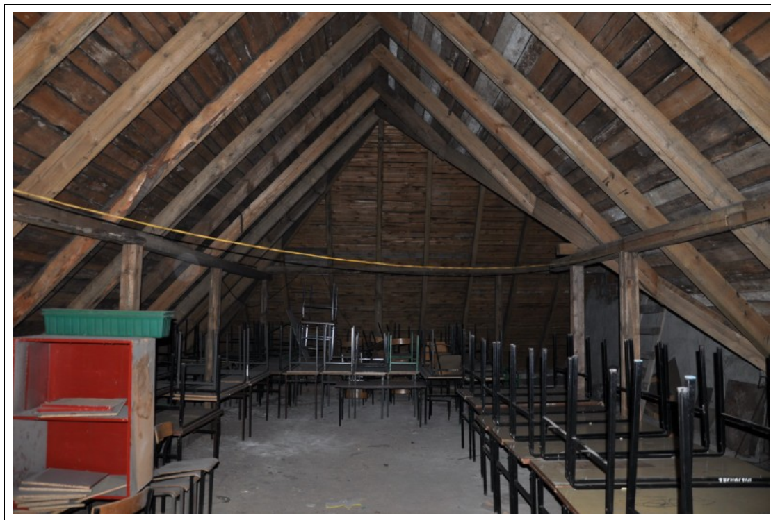
FOT 1-028. 04.06.2012 – Żernica ul. Leopolda Miki 37 - obiekt szkolno-przedszkolny - widok ogólny więźby dachowej segmentu F.
