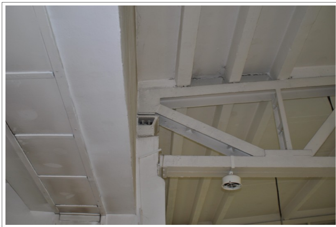
FOT 1-033. 04.06.2012 – Żernica ul. Leopolda Miki 37 - obiekt szkolno-przedszkolny - zbliżenie poprzedniego ujęcia - widoczne ślady przemieszczeń płyt dachowych.
