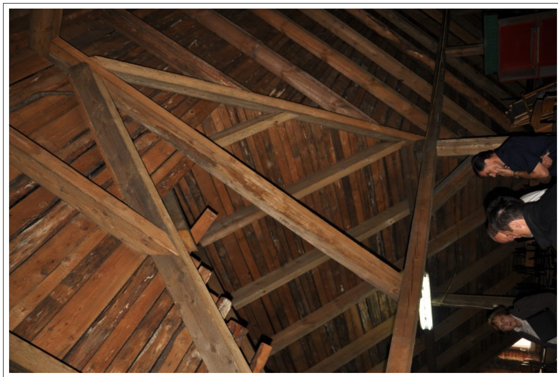
FOT 1-030. 04.06.2012 – Żernica ul. Leopolda Miki 37 - obiekt szkolno-przedszkolny - poddasze segment F - fragment więźby z krokiewmi koszowymi, niestaranne wykonanie.
