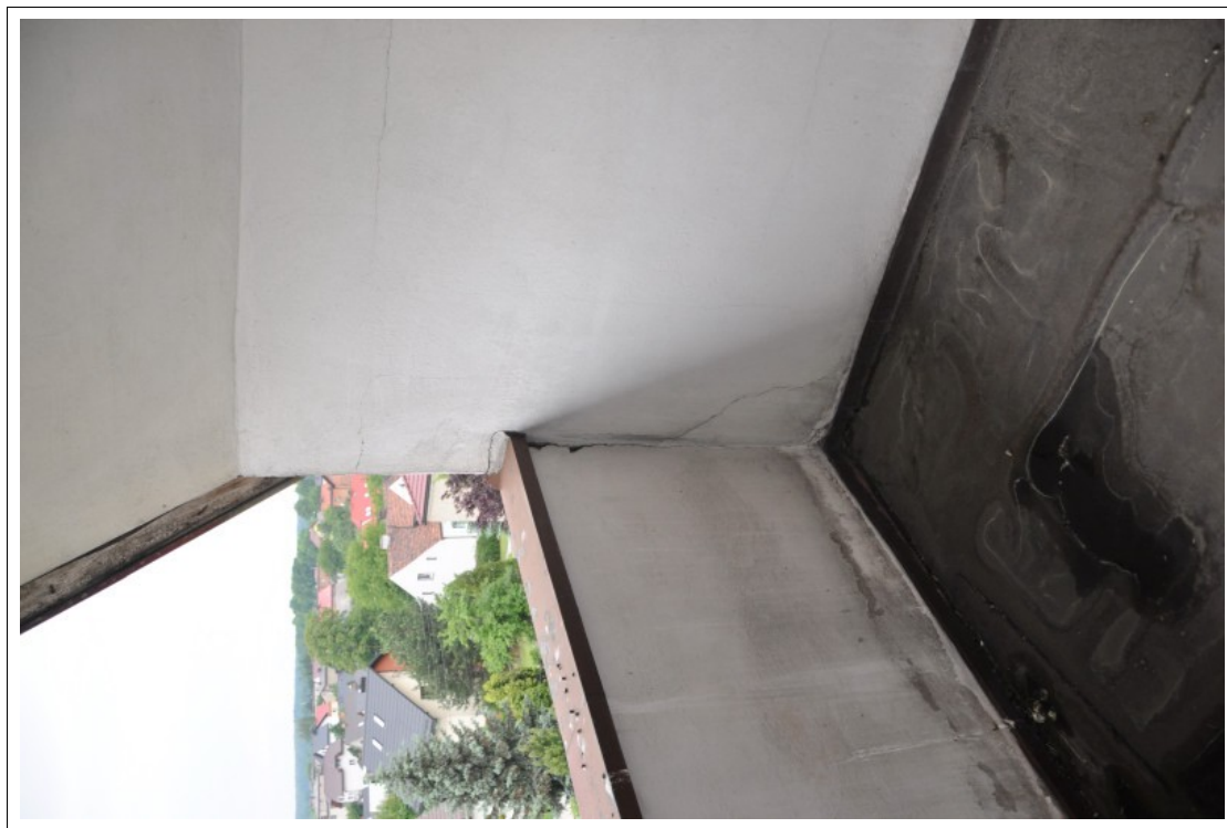
FOT 1-016. 04.06.2012 – Żernica ul. Leopolda Miki 37 - obiekt szkolno-przedszkolny - ścięta balustrada i ściana boczna wykuszu głównego portalu na skutek przemieszczeń skorupy zadaszzenia .
