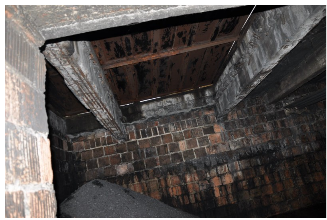
FOT 1-038. 04.06.2012 – Żernica ul. Leopolda Miki 37 - obiekt szkolno-przedszkolny - piwnica - widoczny skorodowany beton i odsłonięte oraz skorodowane zbrojenie belek stropu nad zsysem opału.
